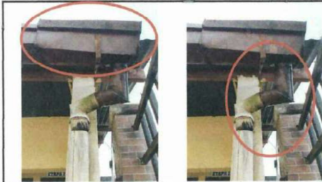
FOTO 1: El canal que se encuentra a mano de izquierda en la entrada del establecimiento por tener ya varios años en uso está en deterioro y cuando llueve por consecuencia el agua se sale por todos lados.
