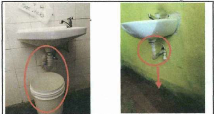
FOTO 4: Los lavamanos en aulas tienen deficiencias como lo son el que no desfogan el agua al drenaje sino que se sale por el tubo que debe llevarla a la misma y no cuentan con una base correcta para uso.
